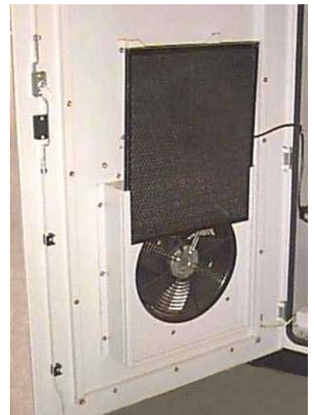
DC fan fitted on door
